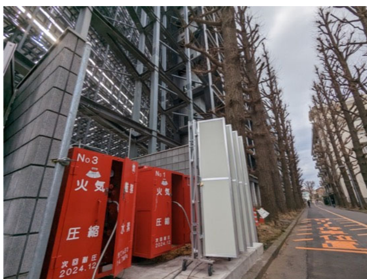
図3 廃プラスチックから生成した水素のカードル庫
