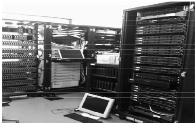
サーバー室のマシン
